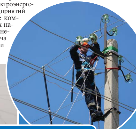
С 90-х годов (фото слева) до настоящего времени от работы энергетиков АО «Облкоммунэнерго» зависит надежность электроснабжения жителей Саратовской области.
